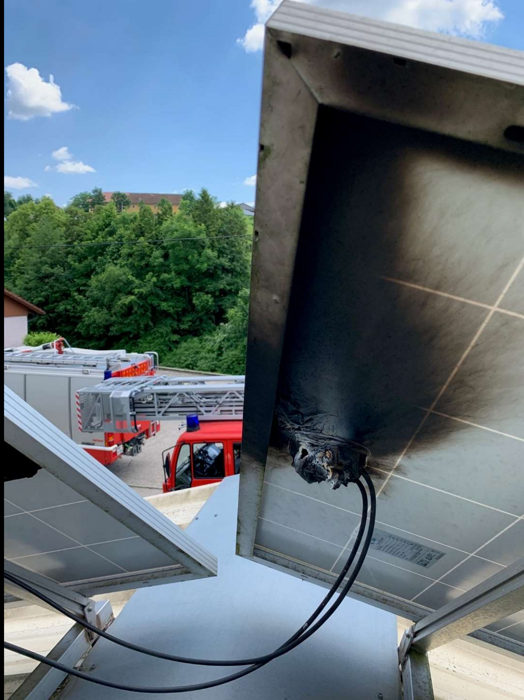
06.10.2023 – Brand PV-Anlage in Grieskirchen
